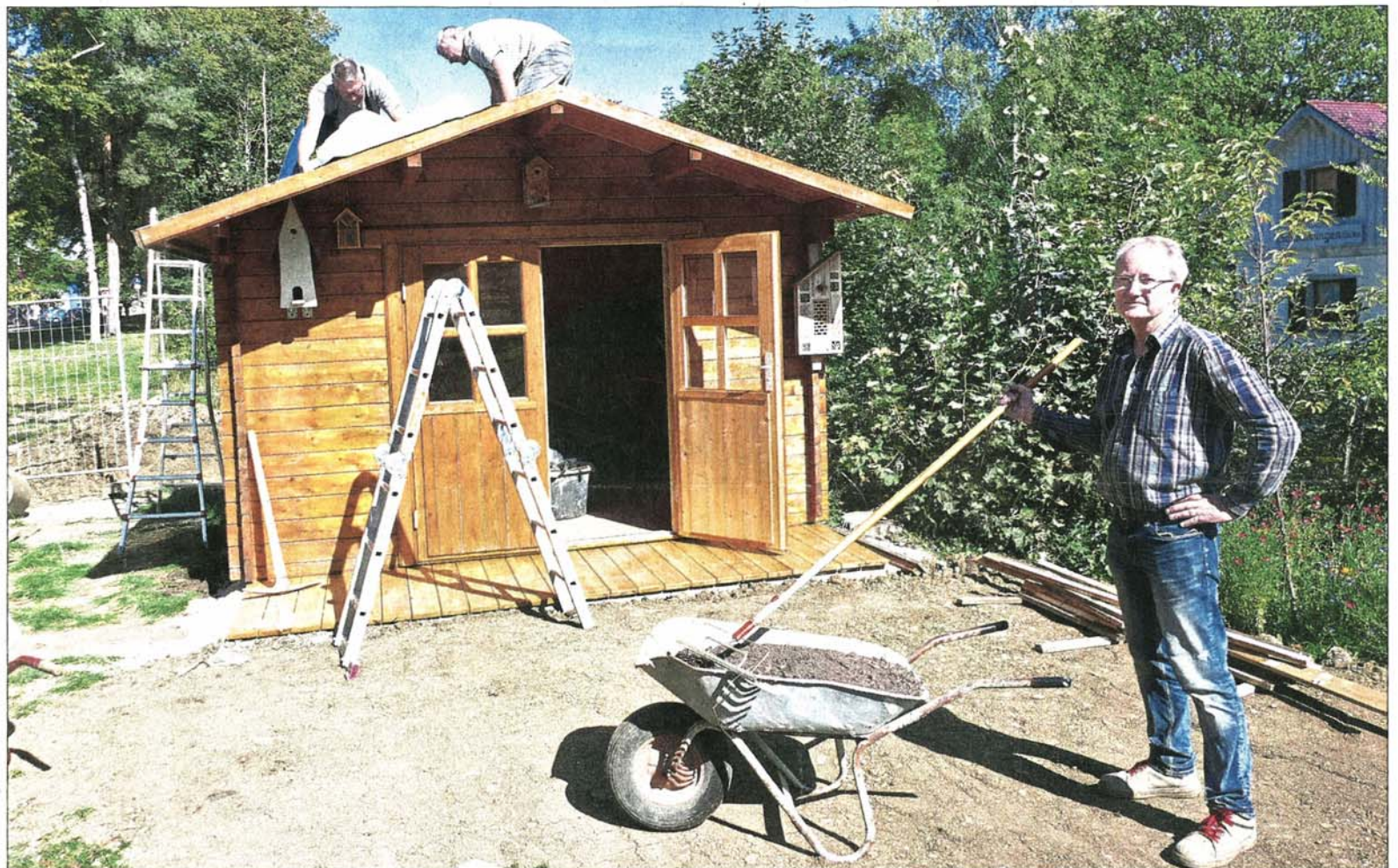
Ein reger Verein sind die Modelleisenbahnfreunde, die parallel zur Neugestaltung des Freigeländes planen, die Galerie als Veranstaltungsort zu etablieren. Elmar Schlenker (von links), Frieder Liebermann und Thomas Rees nutzen das trockene Wetter für Arbeiten im Freien.
